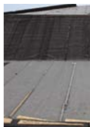
Po odstranění provizorního zakrytí lepenkou bude střecha na mírnějším sklonu zatravněná, na prudším bude krytina z břidlice
