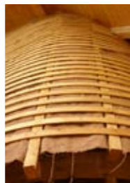
Vnější smrkové hrázdění a přírodní protivětrová zábrana (juta namočená v jílovém šlemu)
